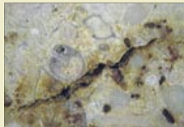
Blaauw cs. waren erg nieuwsgierig naar de samenstelling van de rode kleur in deze scheur.
